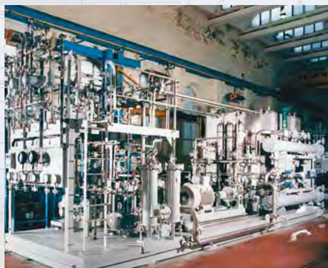
Refroidissement d'air comprimé
