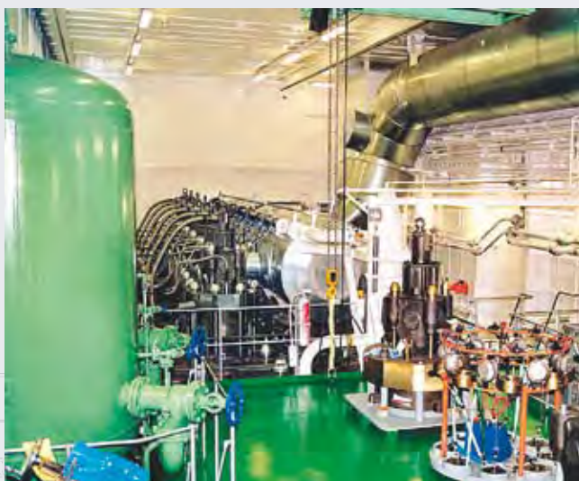
Refroidissement de moteur de navire
