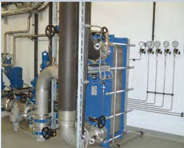
Refroidissement d'huile dans les centrales électriques.
