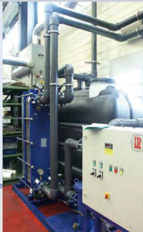
Refroidissement d'huile de lubrification pour presses d'extrusion.
