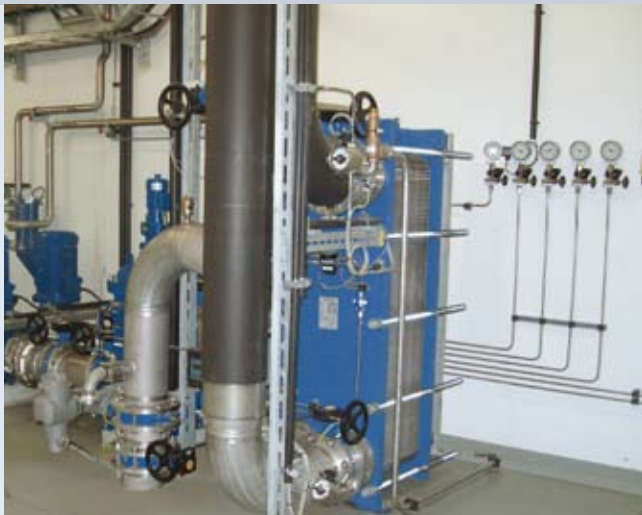
Hydraulik- ölkühlung im Kraftwerk
